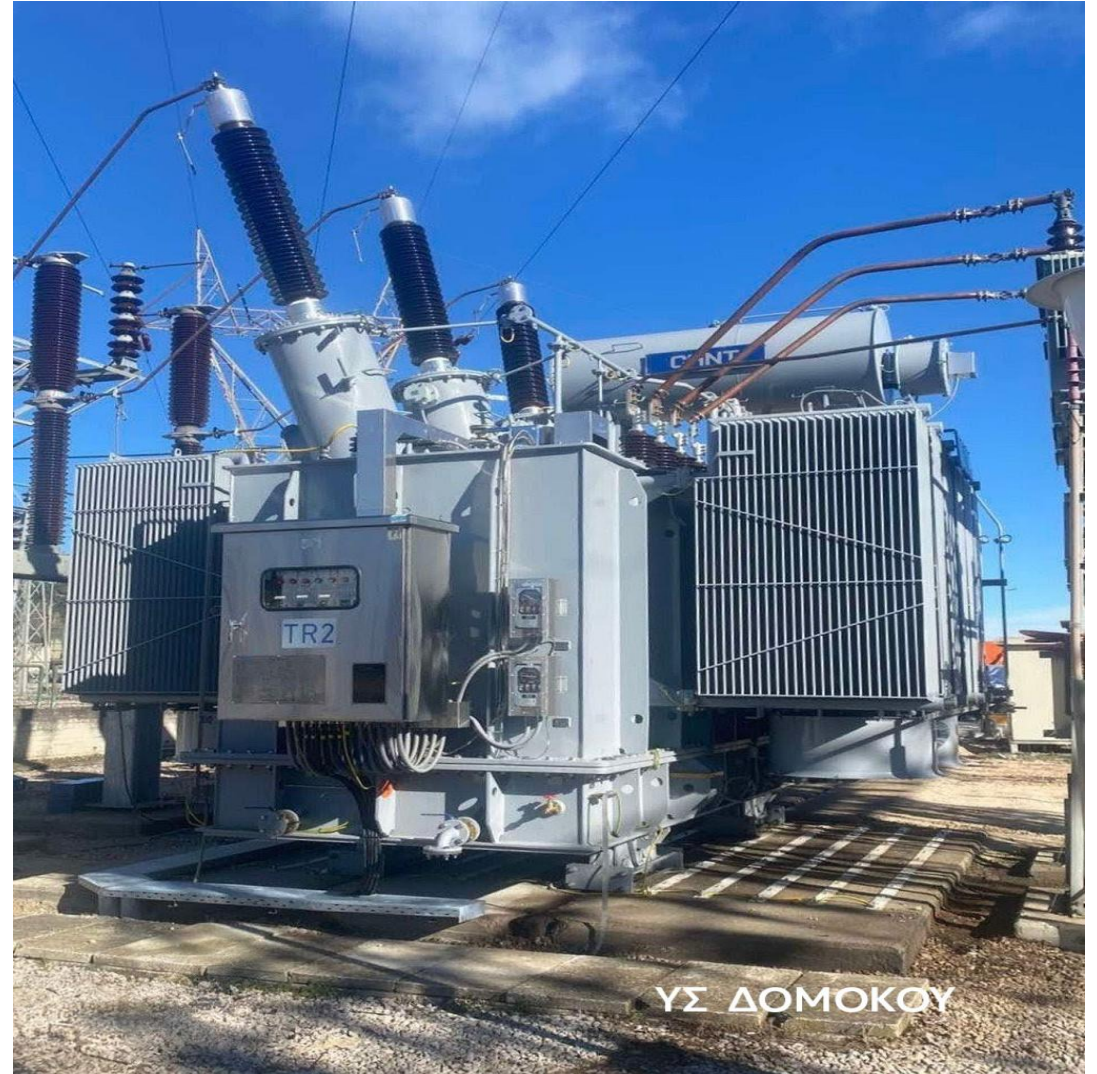
Επαύξηση ισχύος ΔΕΔΔΗΕ
